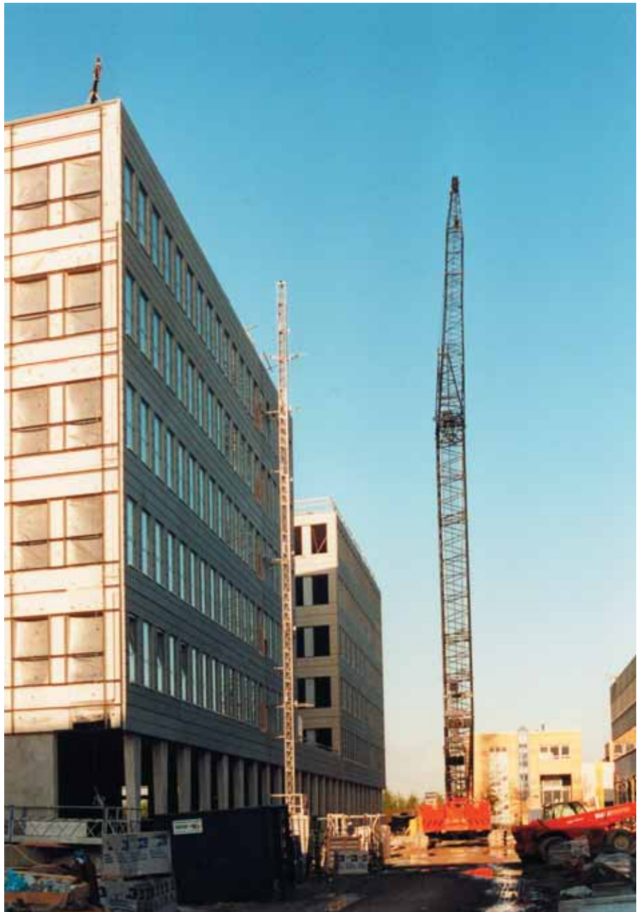
Foto 5.037: Kantoorgebouw Schiphol Rijk heeft een zeer kleine bouwplaats. De montage geschiedt vanaf de wagen
