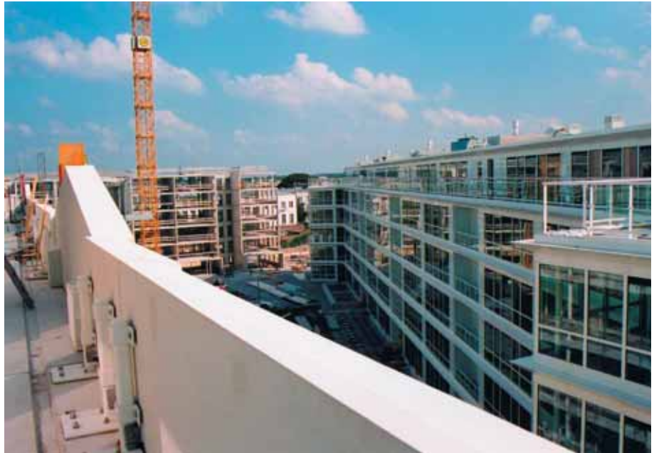
Foto 5.043: Een beeld van het bovenste gestapelde element, dat ter plaatse van de dakvloer horizontaal moet worden gesteund
