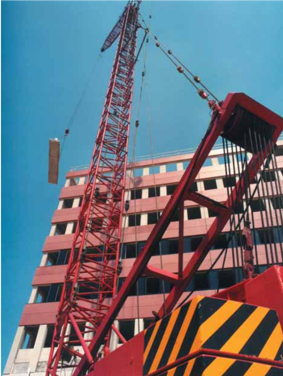
Foto 5.036: Montage van een element direct vanaf de wagen bij het kantoorgebouw Bolduc in 's Hertogenbosch
