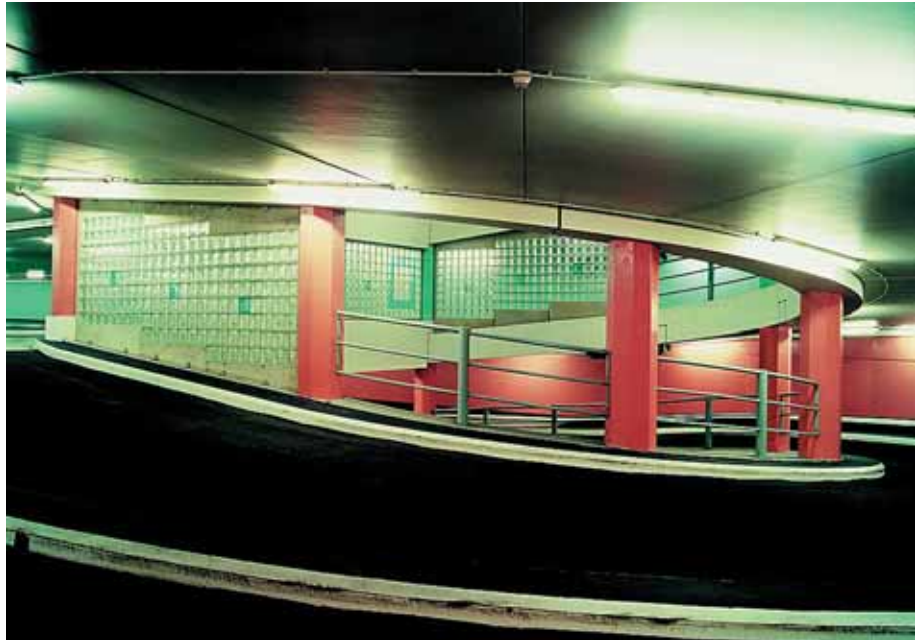
Foto 5.016: De inritconstructie is ook uit prefab-betonelementen opgebouwd. De massieve vloerplaten zijn verlopend in breedte en enigszins gewrongen, omdat de hoogteverschillen bij verschillende stralen tot stand komen
