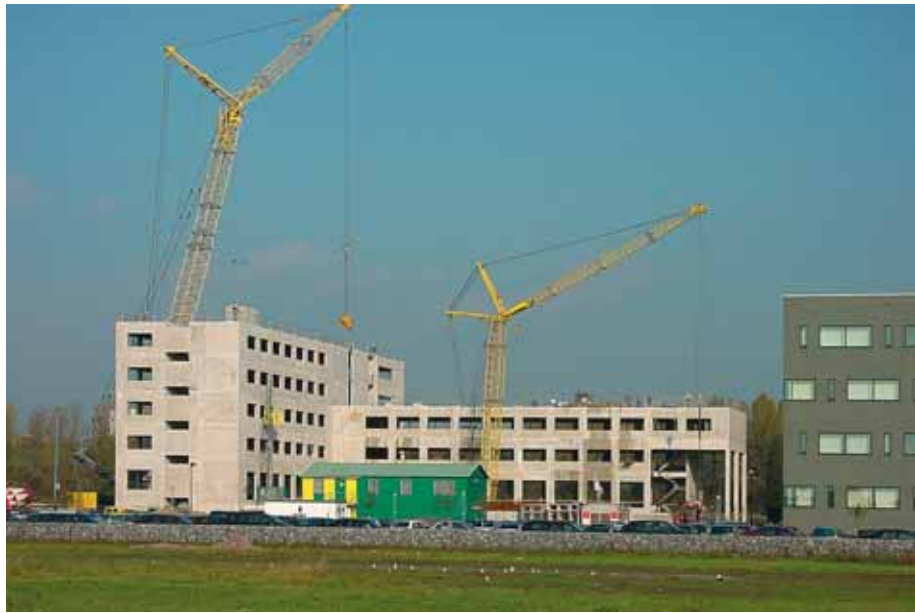
Foto 5.014: De montage van wand- en vloerelementen gebeurt in een hoog tempo. Het werk op de bouwplaats voor de montage van de ruwbouw is geminimaliseerd; de montagetijd is daardoor bijzonder kort
