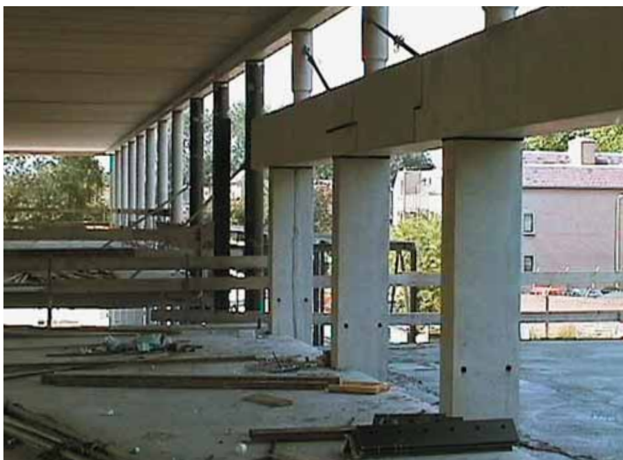
Foto 10.110: Een aanzicht van binnenuit. De kanaalplaten rusten op de draagbalk onder de wanden. Wand is echter stijver dan balk!
