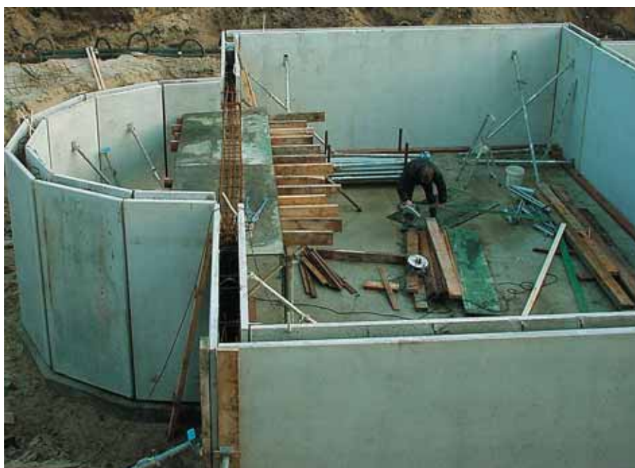
Foto 10.144: Holle wand horizontaal toegepast voor een kelderwand, gebogen vorm, veelhoek, geen probleem, maar dan wel verticaal
