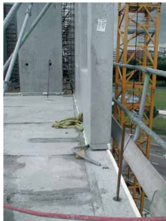
6 | Stelanker in onderliggende wand
