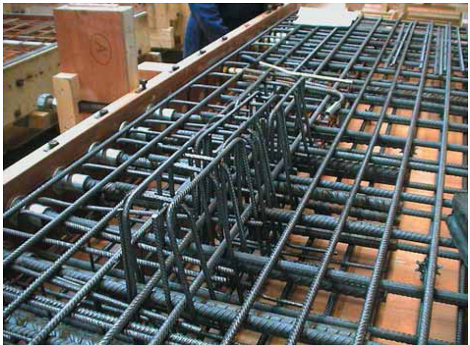
Foto 10.129: Nokwapening en stekankers met bouthouders, hier niet zo zwaar gewapend
