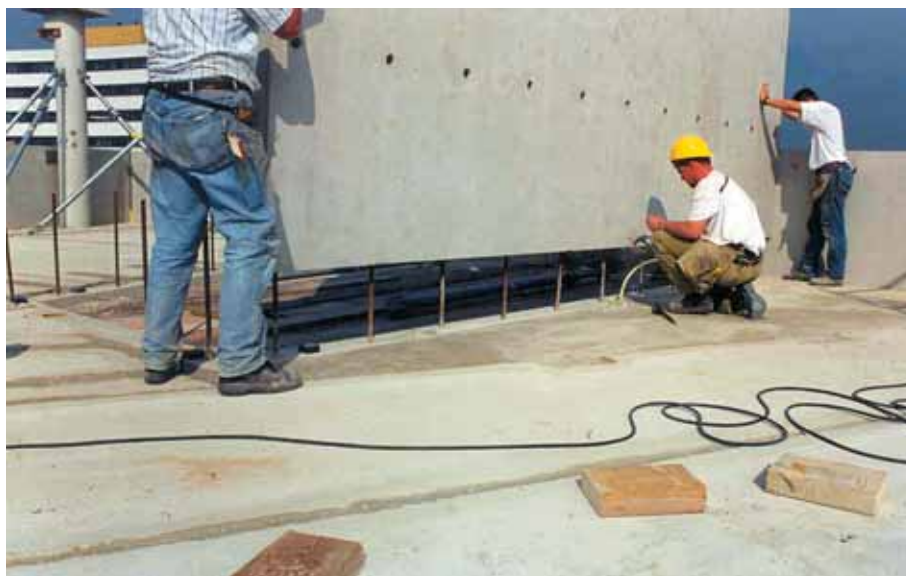
Foto 10.095: Kolom op de achtergrond ruim geschoord. De wand zakt over de stekken heen
