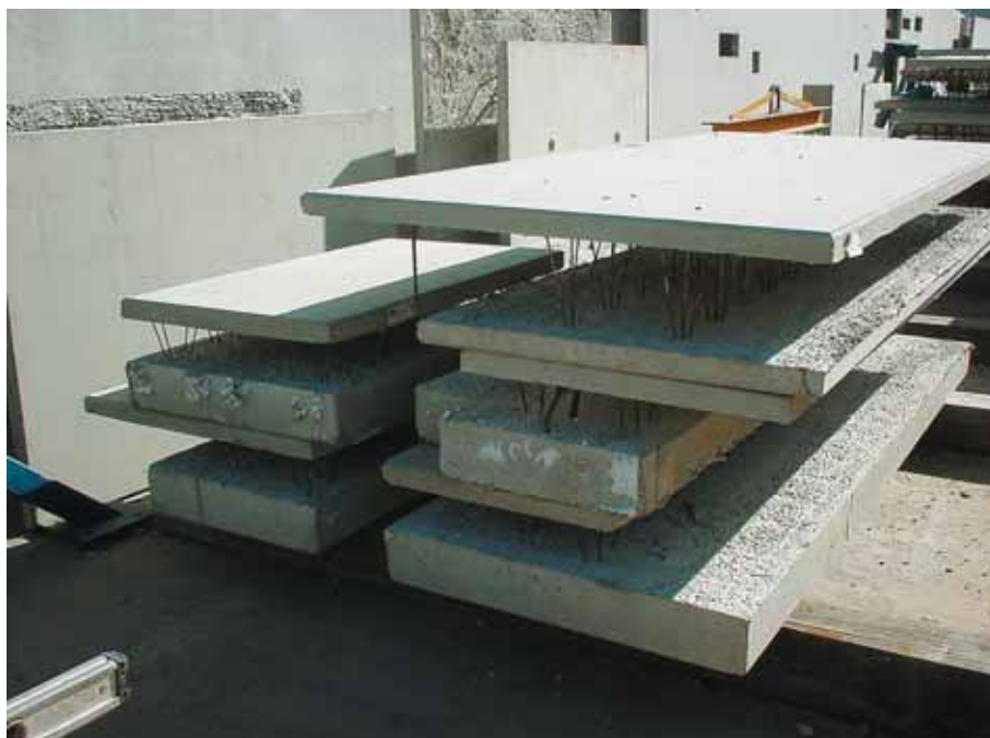
Foto 10.143: Ook hier is sprake van een ongelijke schildikte. De vereiste wandwapening is opgenomen in de schillen
