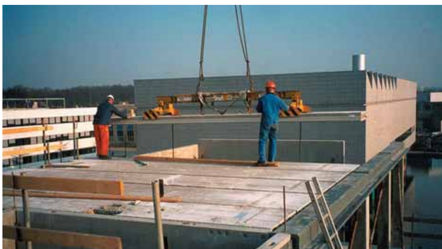
Foto 10.042: Montage kanaalplaat, de veiligheidsketting van de klem ook hier loshangend
