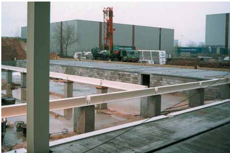
Foto 10.087: Het overzicht van de stalen balken
